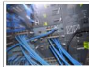
Réseau de télécommunications
