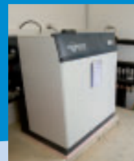
Pompe à chaleur de l'école de Montbrun-Lauragais
