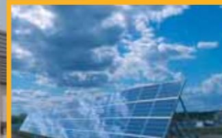
Des panneaux solaires permettent de chauffer l'eau chaude sanitaire
